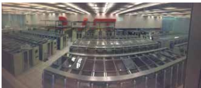
Foto 5: het data center van CERN
